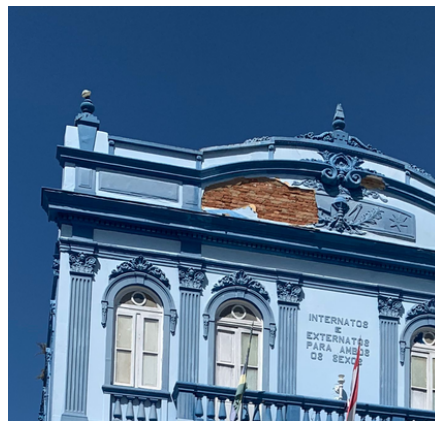
Imagem 3 - Patologia Fonte: Acervo Próprio
